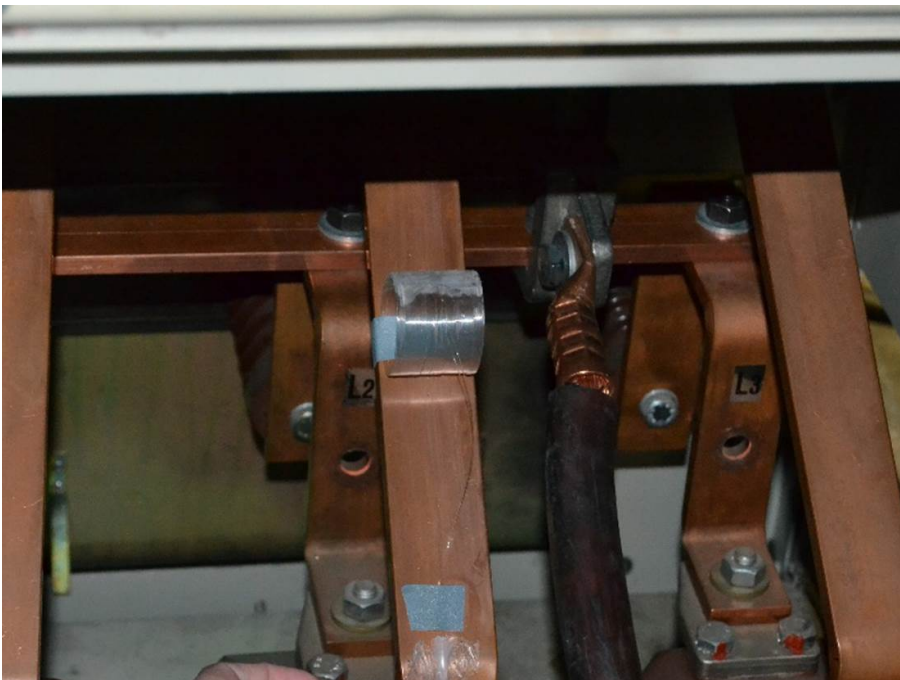
Abb. 1: Faseroptischer Sensor zur frühzeitigen Kurzschlussdetektion auf der mittleren Stromschiene einer Schaltanlage.
